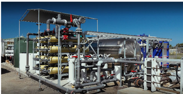
トレビ社の実証実験用海水淡水化プラント
